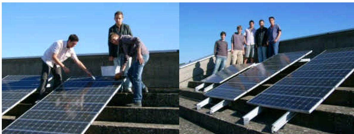
Abbildung 43 und 44: Service-Team mit der PV-Anlage u. bei der Reinigung der Paneele.
