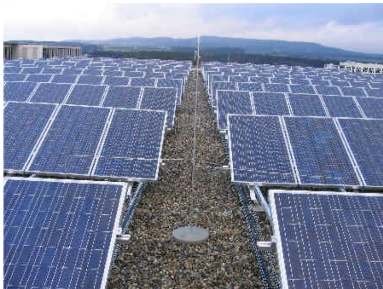
Abbildung 106: 50-kWp Anlage mit monokristallinen Zellen auf dem Dach der Turnhalle.
