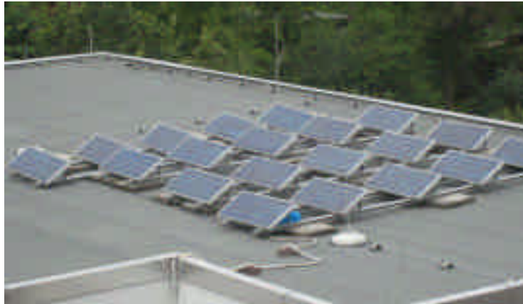
Abbildung 20: Die Solaranlage der Fichtenberg-Oberschule.
