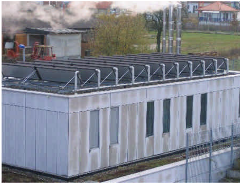
Abbildung 105: Die thermische Solaranlage.
